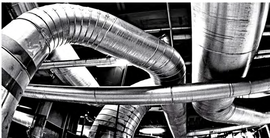
Figura 9: "Accèsit: " Tuberías en central térmica" realizada por J.M. Maiquez.
